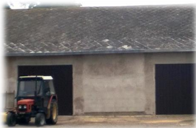
Rysunek 1. Wyroby azbestowo-cementowe: na górze z lewej- płyty faliste, na dole po prawej- płyty płaskie (źródło: materiały własne).
